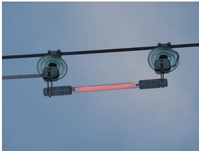
Рис. 1. Лампа BALISOR с антенной, на высоковольтном проводе
